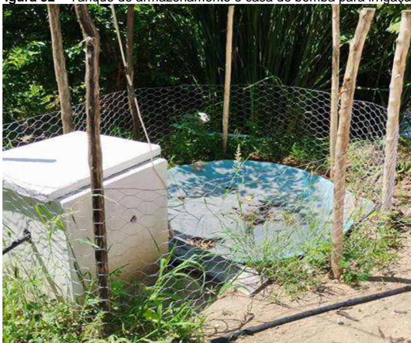
Figura 32 – Tanque de armazenamento e casa de bomba para irrigação.
