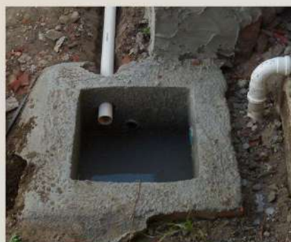
CX. INSPEÇÃO PASSO 02
