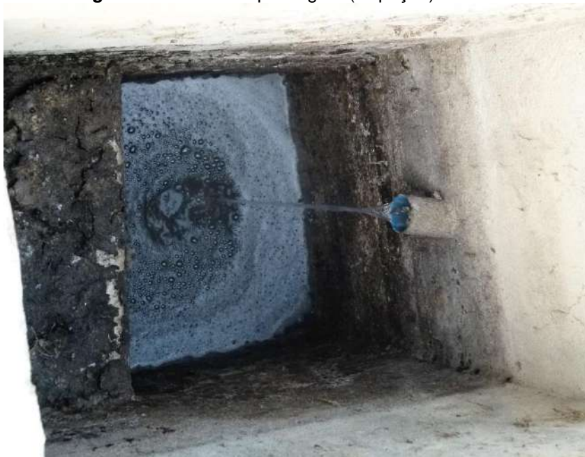
Figura 35 – Caixa de passagem (inspeção) existente.
